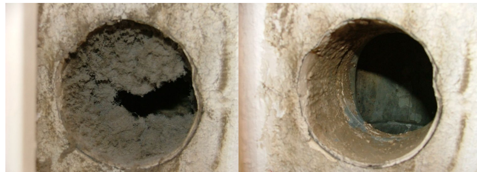
Ventilatiekanaal vóór en na de reiniging
