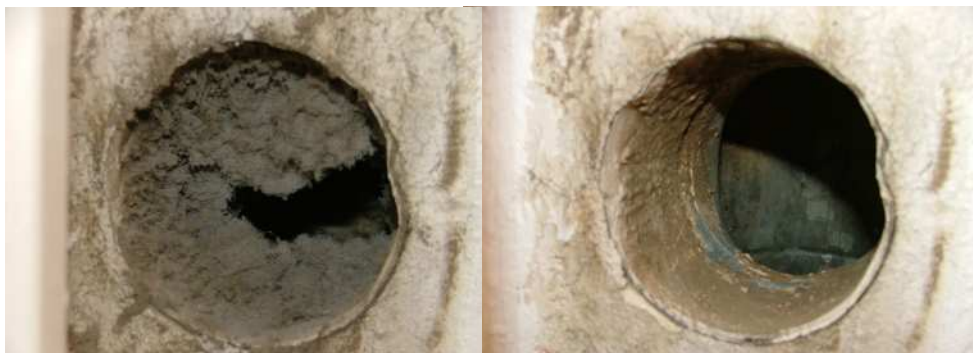
Ventilatiekanaal vóór en na de reiniging
