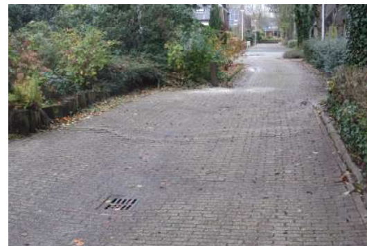
De Bergse Maas is behoorlijk verzakt
