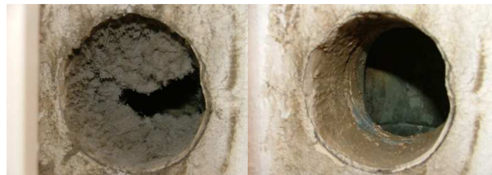
Ventilatiesysteem vóór en na de reiniging
