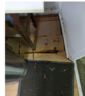
Door het water was de vloer van het kantoor behoorlijk beschadigd
