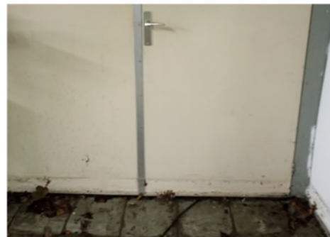
De toegangsdeuren waren aan de onderzijde door het water onherstelbaar uitgezet
