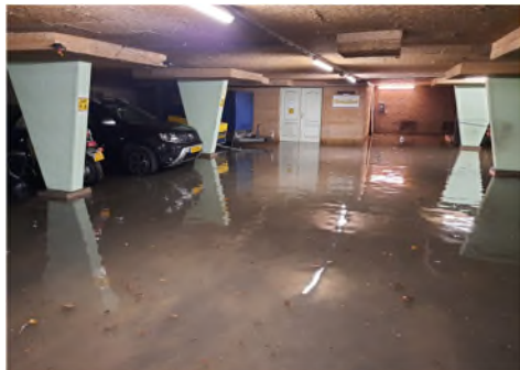
Veel water in de parkeergarage
