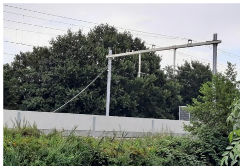
Geluidsscherm aan de kant van Koningshof
