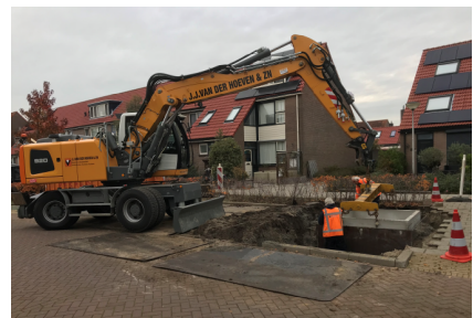
Plaatsing van de restafvalcontainers
