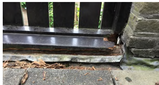
Rot in de onderbalk van de houten balkonbalustrade.
