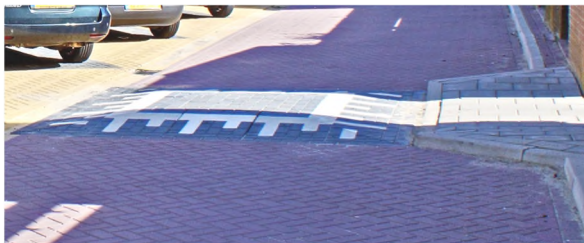
Bedoeld om het verkeer te remmen, maar ook een veroorzaker van autoschade bij het te snel passeren
